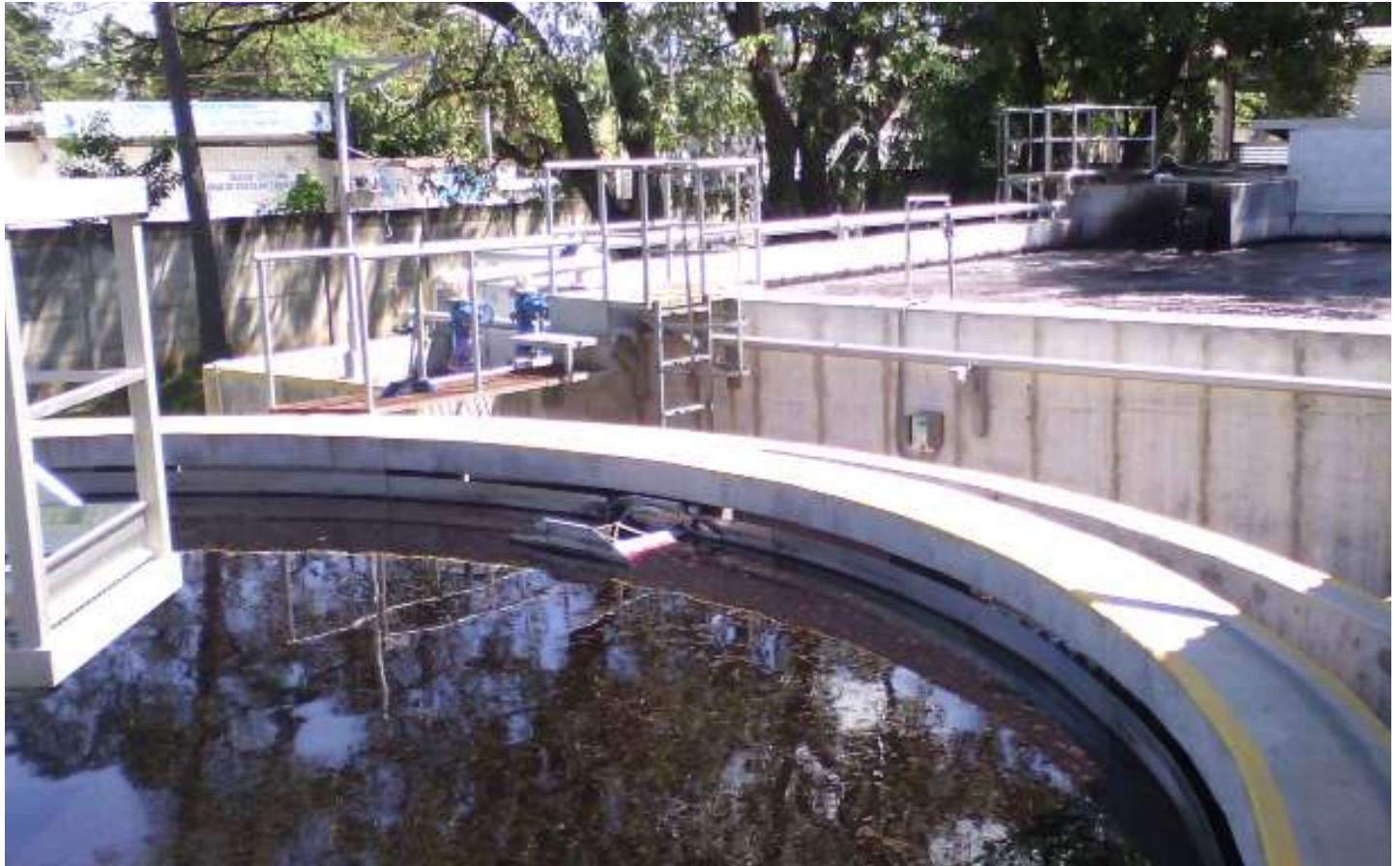
SISTEMA BIOLÓGICO INSTALADO EN HILCASA
