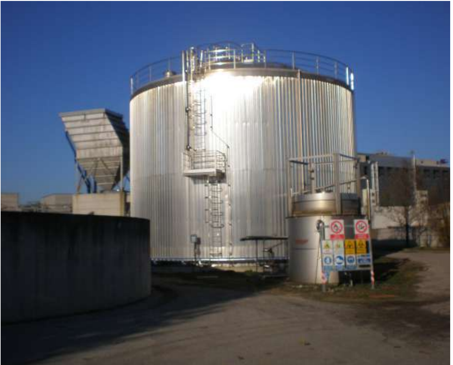
REACTOR UASB INSTALADO EN FÁBRICA DE CERVEZA
