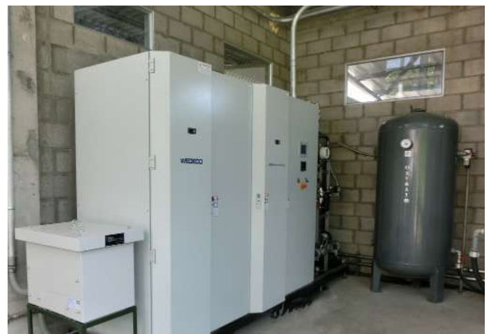
GENERADOR DE OZONO Y PSA
