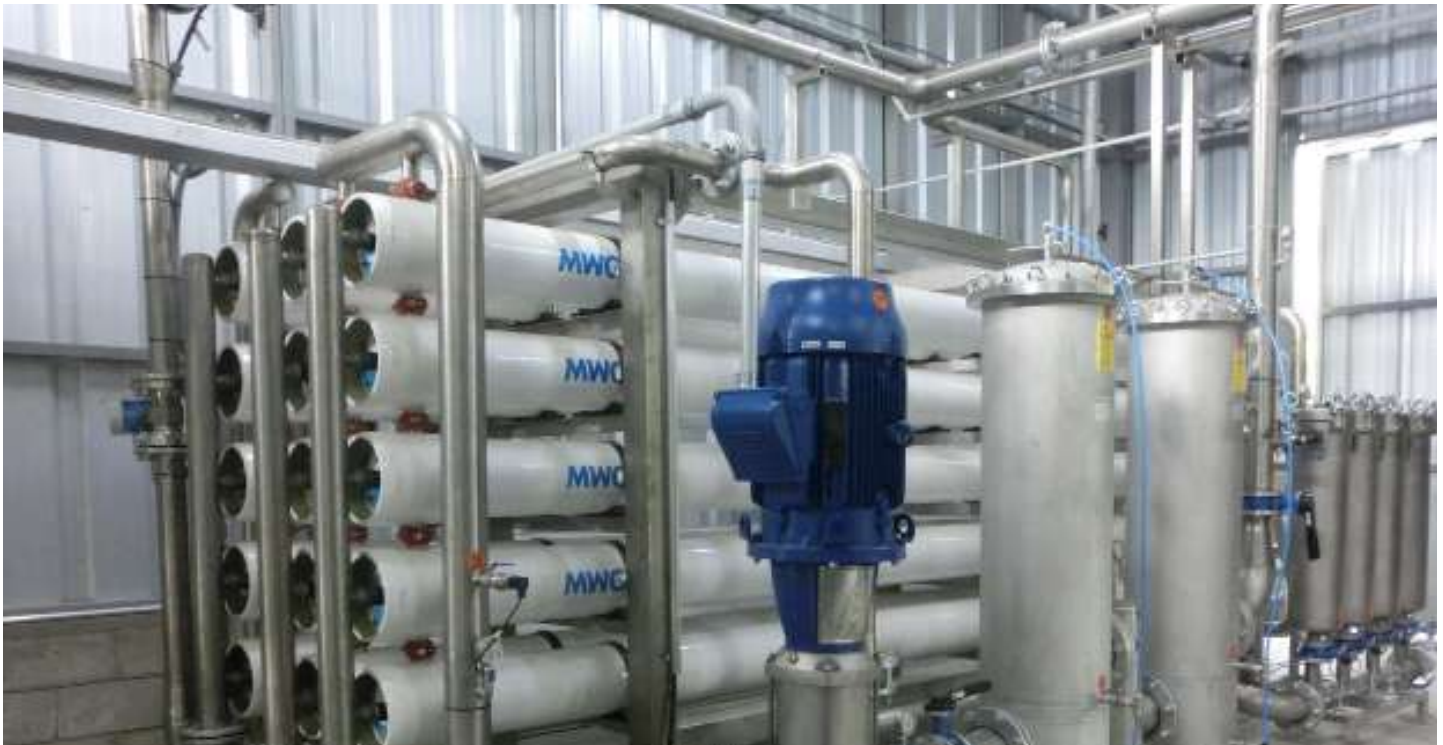
SISTEMA DE OSMOSIS INVERSA APLICADO PARA RECUPERACIÓN DE AGUA EN PLANTA A DESCARGA CERO (ZLD)
