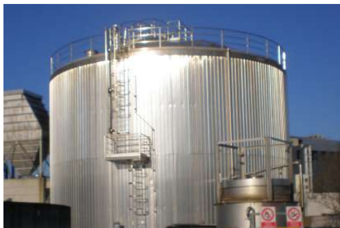
REACTOR UASB INSTALADO EN FÁBRICA DE CERVEZA
