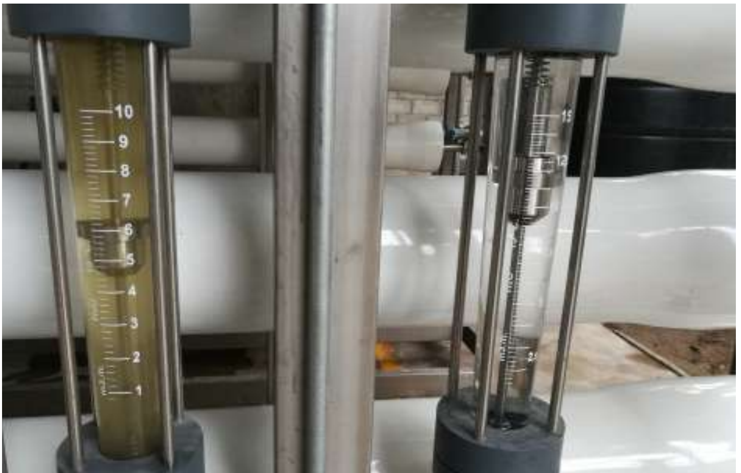
CONCENTRADO (IZQUIERDA) Y PERMEADO (DERECHA) DEL SISTEMA DE OSMOSIS INVERSA
