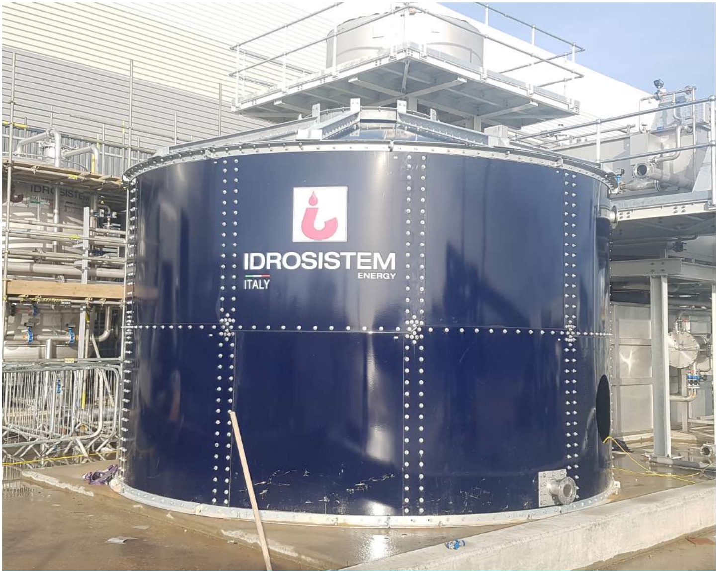
TANQUE DE ACERO VITRIFICADO CON GRAVITY STRAINER Y BAND FLOAT INSTALADOS ENCIMA.
