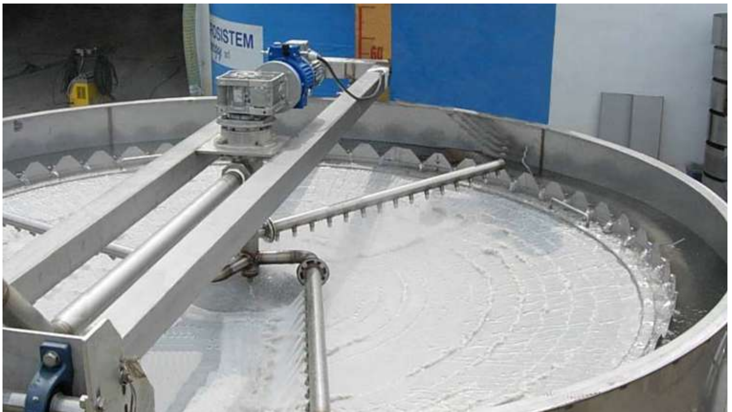
GRAVITY STRAINER INSTALADO EN PLANTA DE LA INDUSTRIA SPUNLACE
