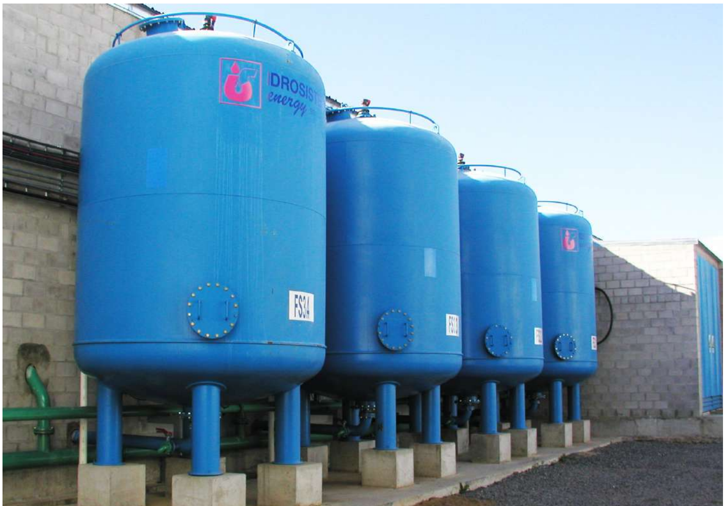
FILTROS DE ARENA INSTALADOS EN FÁBRICA SIDERÚRGICA
