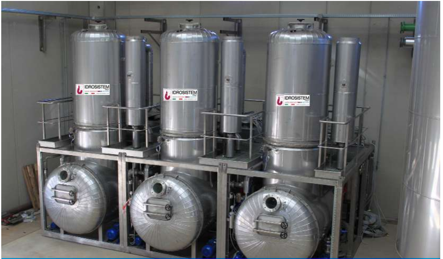
EVAPORADOR DE 3 ESTADÍOS INSTALADO EN PLANTA DE LA INDUSTRIA TEXTIL
