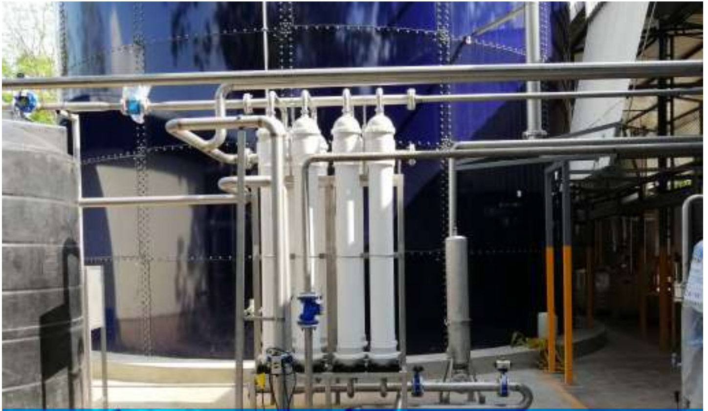
SISTEMA DE ULTRAFILTRACIÓN INSTALADO EN HILCASA
