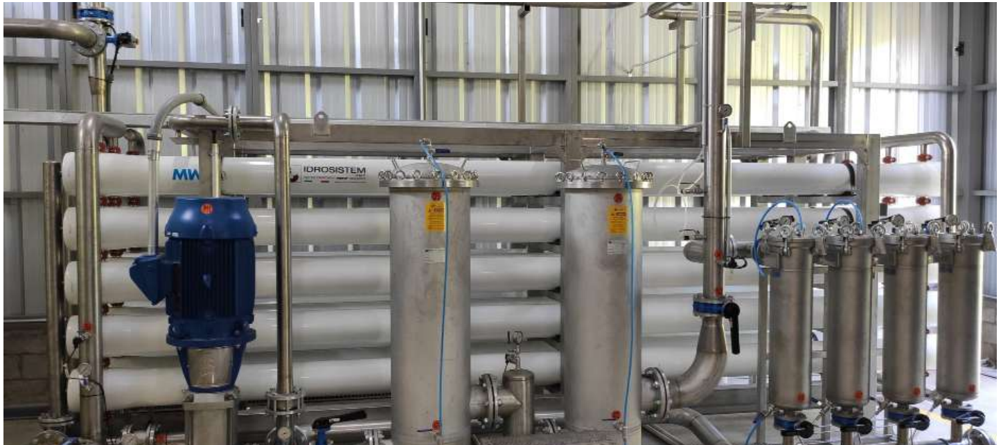
SISTEMA DE OSMOSIS INVERSA INSTALADO EN PLANTA DE RECUPERACIÓN DE AGUAS PARA FÁBRICA DE TEÑIDO
