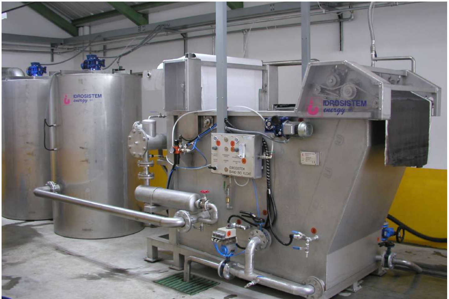
BAND BIO FLOAT INSTALADO EN FÁBRICA TEXTIL (TEÑIDO) EN EL SALVADOR
